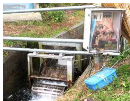
図1 水路に設置した水車装置
