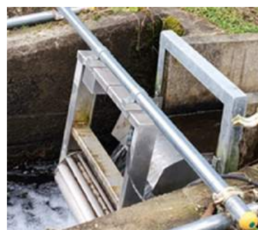
図2 水車装置設置状況
